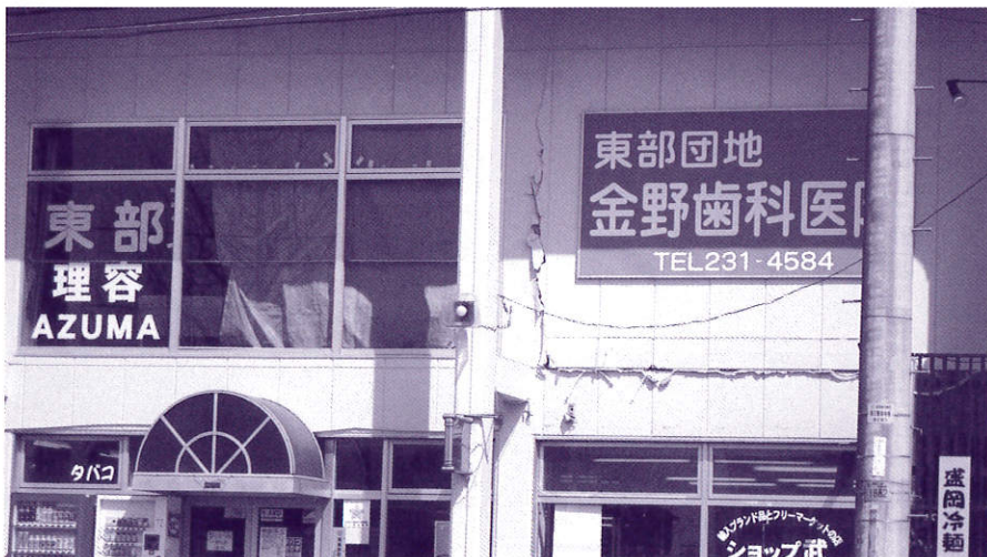
仙台市若林区鶴代町付近／鶴代町工場団地組合棟。ALC板が破損。
