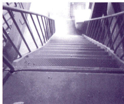
仙台市若林区鶴代町付近／某事務所内部。 貨物エレベーター周囲の壁、ラス網+モルタルの損傷。 歪んだ室内階段。
