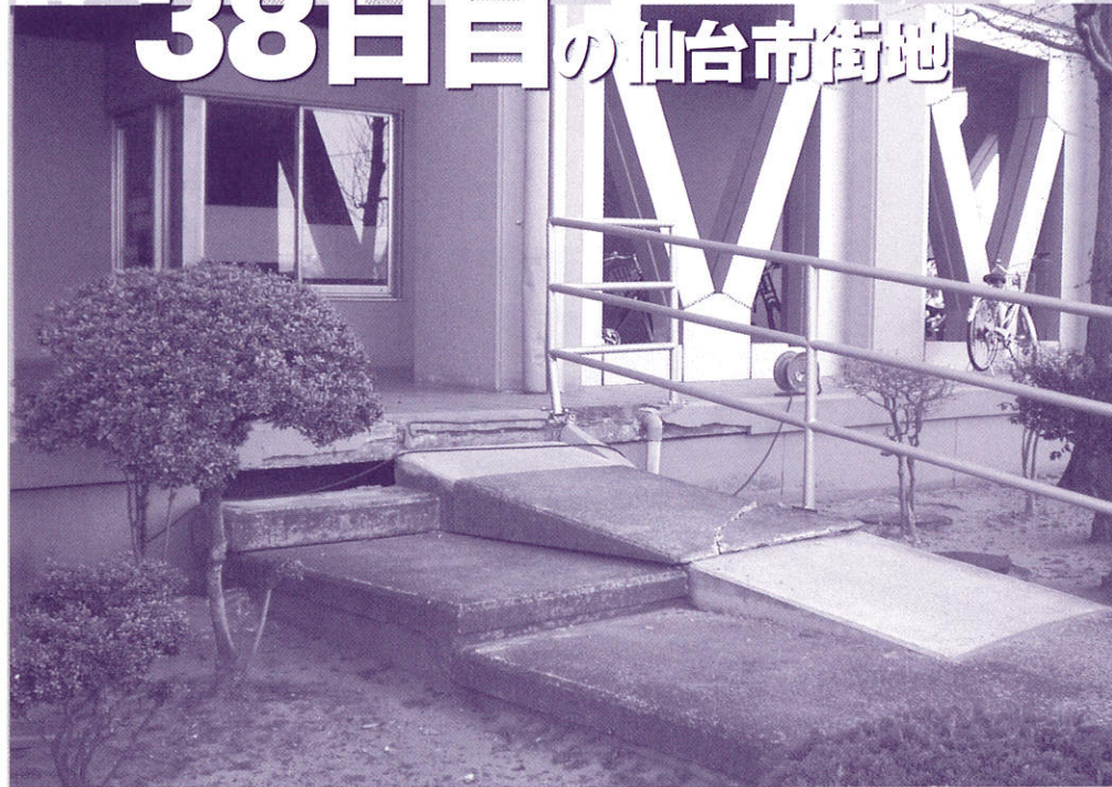
仙台市卸売市場／手摺の曲がり。 建物と周囲地盤の地震時の動きが異なったためと推測。
