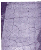
アルカリ骨材反応による亀甲状ひびわれ
